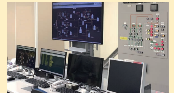
発電所の中央制御室の様子▶
